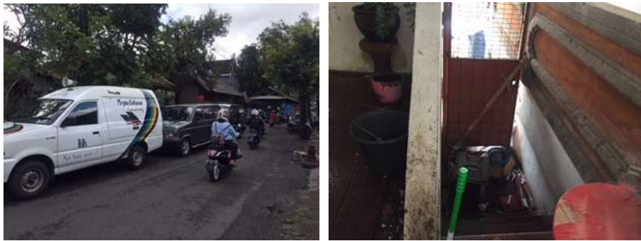
Gambar 1. Lingkungan di Sekitar Perpustakaan Umum Bangli dan Kondisi Gedung Perpustakaan Umum Kabupaten Bangli yang Bocor di Sana-Sini Saat Musim Hujan
